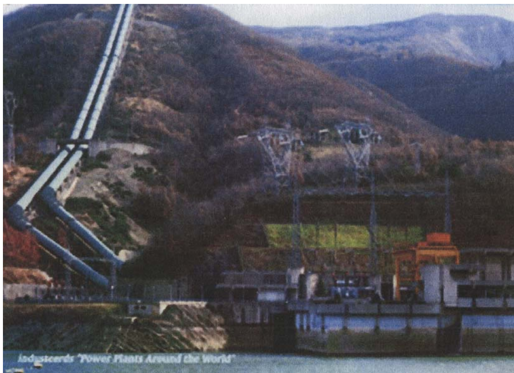
Рис. 2.42. Поверхностный комплекс электростанции Барги с подачей воды к турбине по стальным трубам
