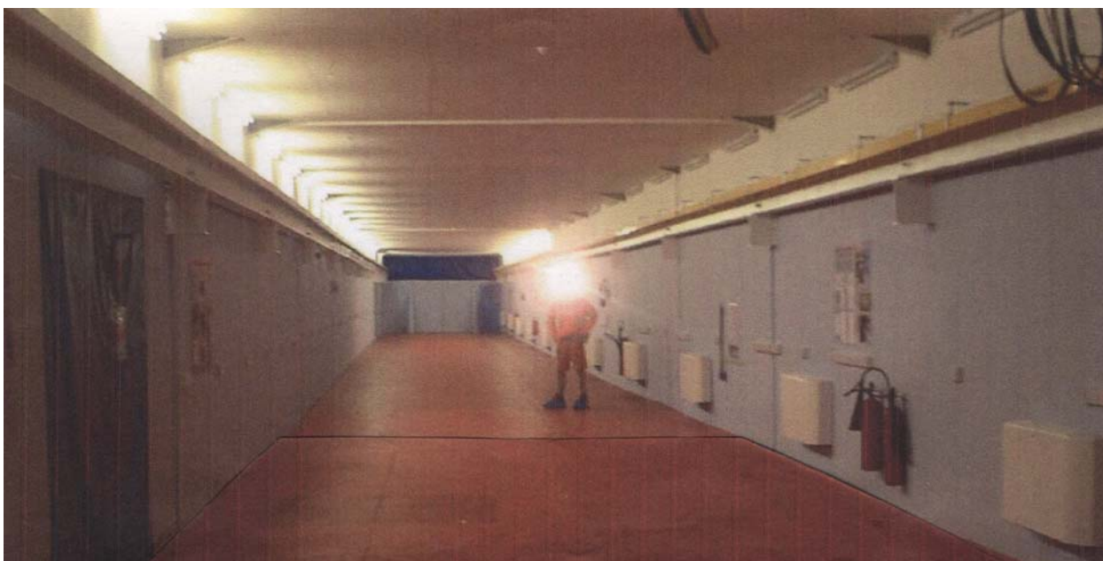
Рис. 4.55. Главный зал подземной физической лаборатории шахты Балби
