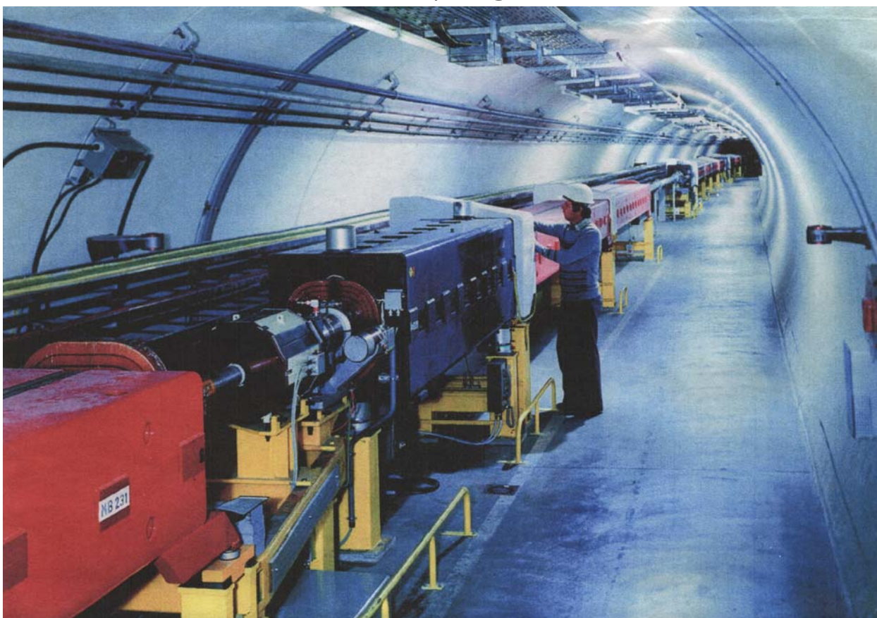
Рис. 4.99. Участок туннеля ускорителя со смонтированным оборудованием
