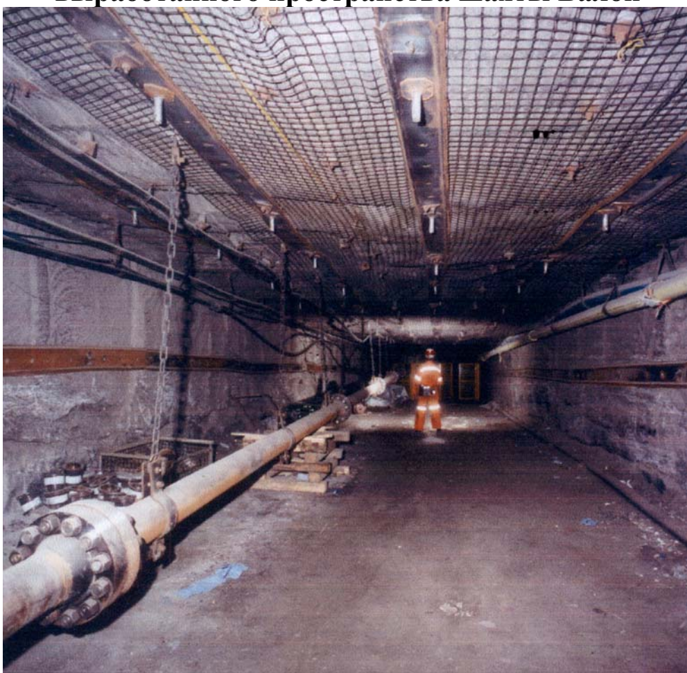
Рис. 1.27 Трубопровод для транспортировки закладочной суспензии в выработки шахты Балби
